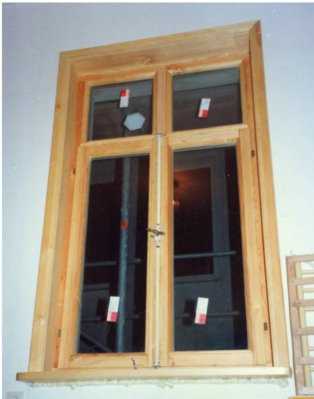
Neues Fenster mit originalgetreuem Holzrahmen und Wärmeschutz-Isolierverglasung (Die Beschläge wurden wieder verwendet)
