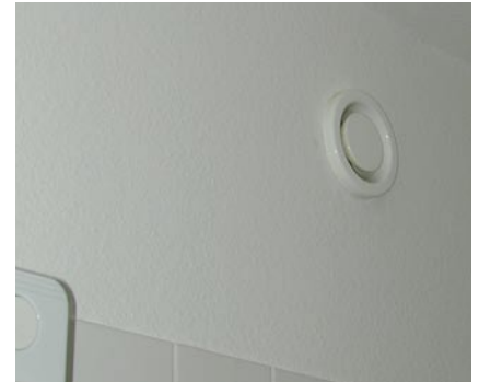
Abluftventil in einem Bad
