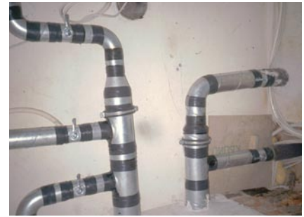
Von unten gegen die Decke fotografiert: Teile eines Kanalnetzes aus Wickelfalzrohr. Alle Verbindungen sind zum Schutz gegen Leckagen mit elastischem Klebeband verschlossen.
