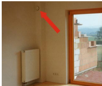
Zuluftventil über einem Heizkörper
